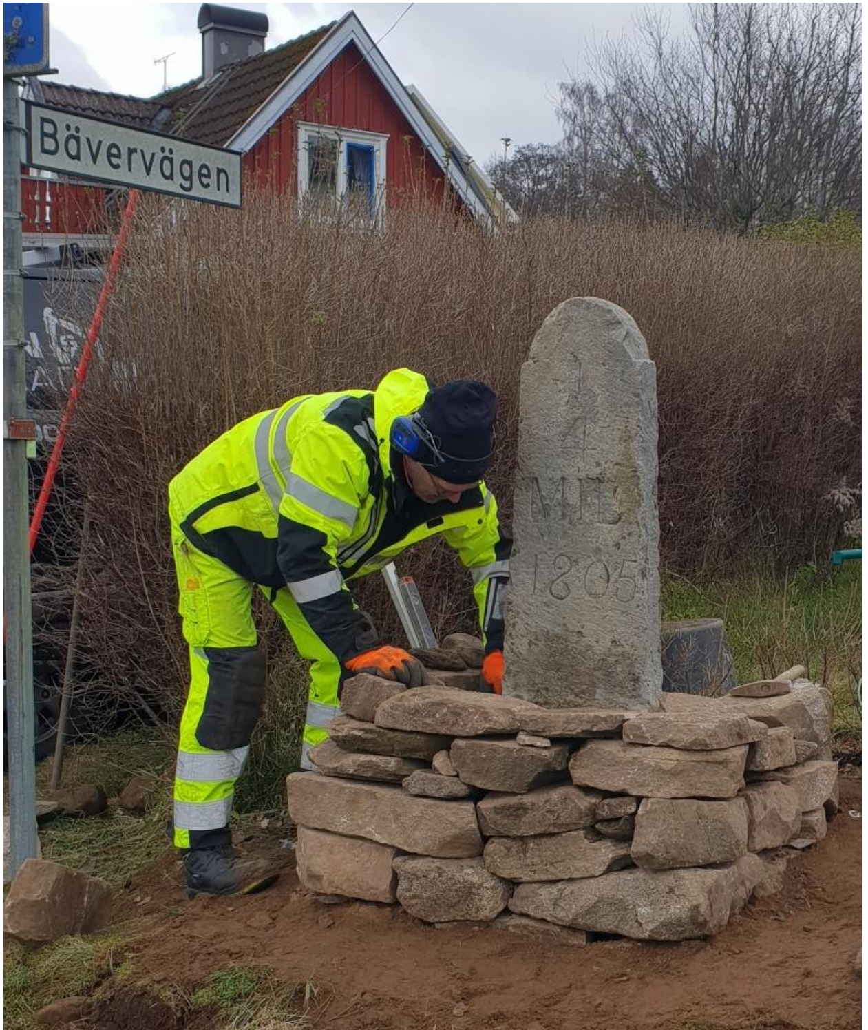
Ett nytt postament muras upp med hjälp av kallmurning. På bilden Anders Axengren från Axengren entreprenad.
